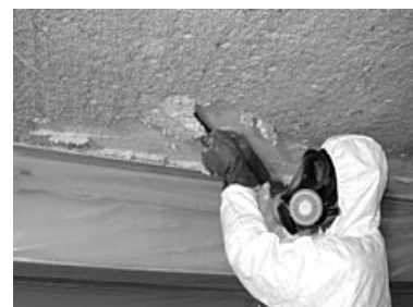
アスベスト吹付けの除去作業 飛散防止を施し、防護服来た作業員が作業(コンステック・アスベスト対策センター提供) YOMIURI ONLINE
