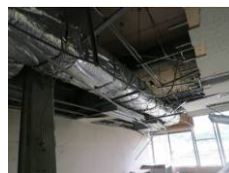
空調ダクトの脱落
