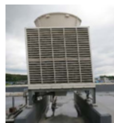
屋上冷却塔の傾斜
