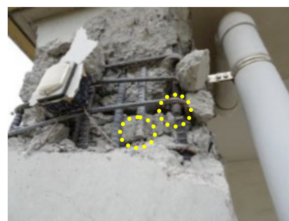
Ⅱ-2-④ 主筋の破断
