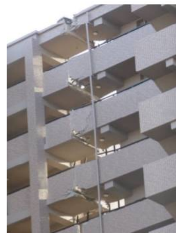
Ⅲ-2-② エクスパンションジョイント、周辺コンクリートの破壊
