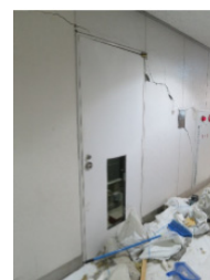
⑤間仕切り壁のひび割れ 防火戸の開閉障害 (空港施設)
