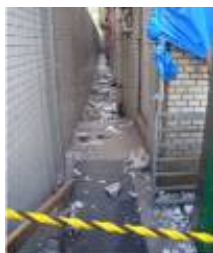
①外壁タイルの剥落(ビル)
