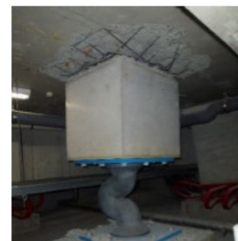
V-2-③ ダンパー取付け基部損傷
