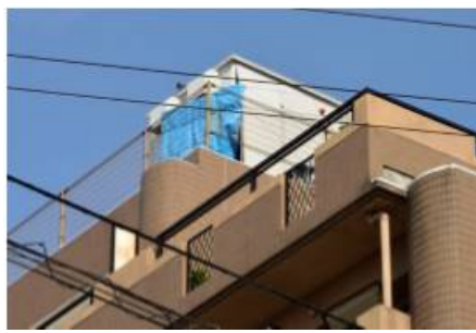
Ⅳ-② 受変電設備の外装パネルの損傷
