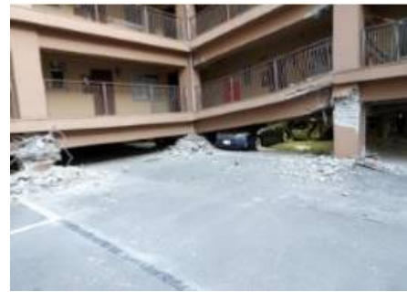
I-④ ①の裏側入り隅部、1階部分の崩壊
