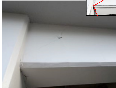
Ⅱ-1-④ 2階梁端のせん断ひび割れ
