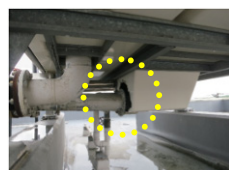
冷却塔と配管接合部の破断
