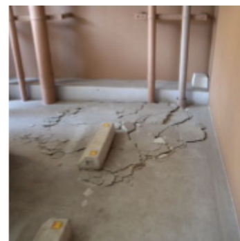
V-2-② 免震層上面の床スラブ損傷
