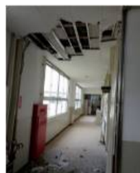
④天井仕上げ材の剥落(学校)
